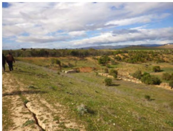
Partie en aval du barrage et fissures dans le bas-côté de la crête
