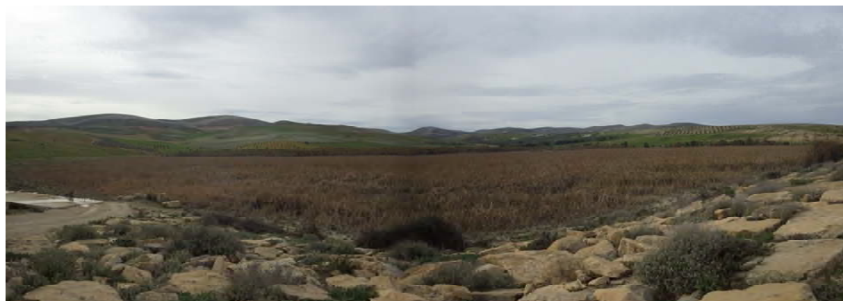
État de l'ensablement du bassin de retenue vu des environs de la partie afflux du déversoir, rive droite du bassin de retenue
