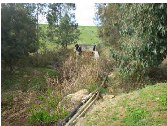
Ouvrage de décharge d'eau collectée et canalisation
