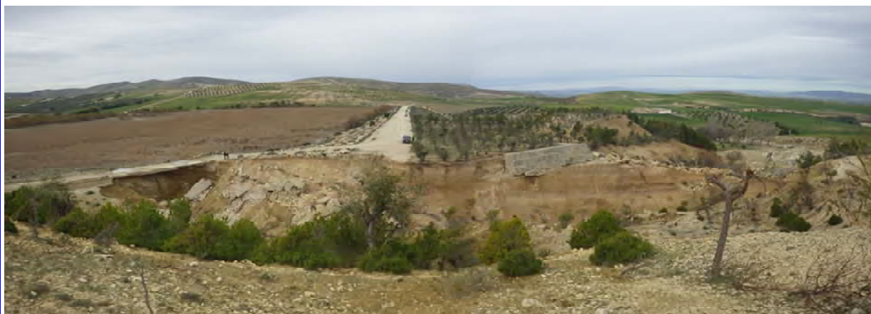
Vue à partir de la rive droite du barrage. Déversoir endommagé et bassin de retenue ensablé
