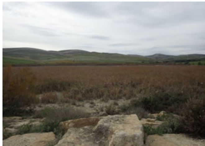
Figure 3.10 Barrage de Seja (SI-11) rempli de sable jusqu'à environ 2 m du niveau d'eau plein à ras bord (le 27 janvier 2014)
