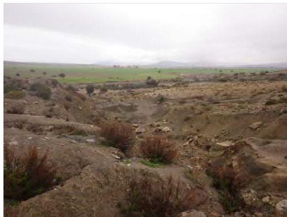
Partie courant rapide du déversoir très érodée
