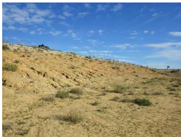
Partie en aval du barrage. Érosion
