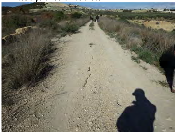
Fissures dans la crête du barrage
