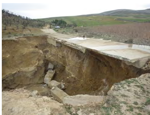
Détérioration de la partie afflux du déversoir
