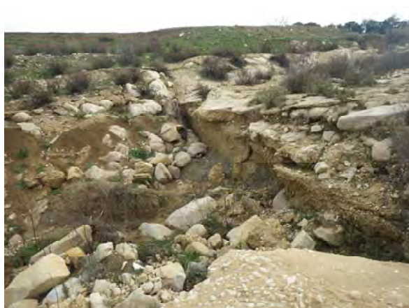
Point de départ du courant rapide du déversoir très érodé
