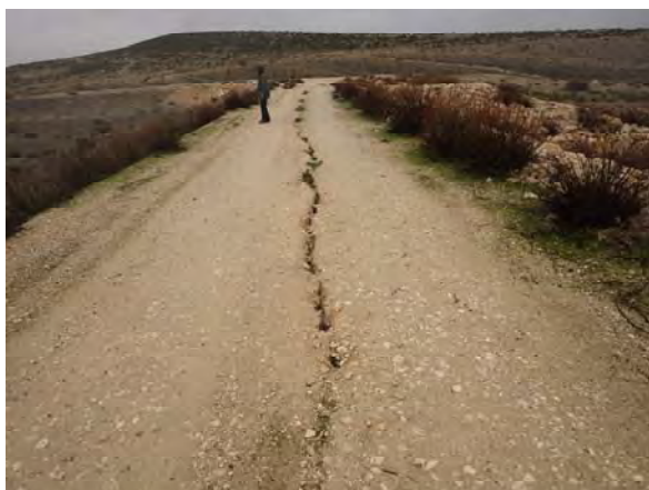
Fissures dans la crête du barrage
