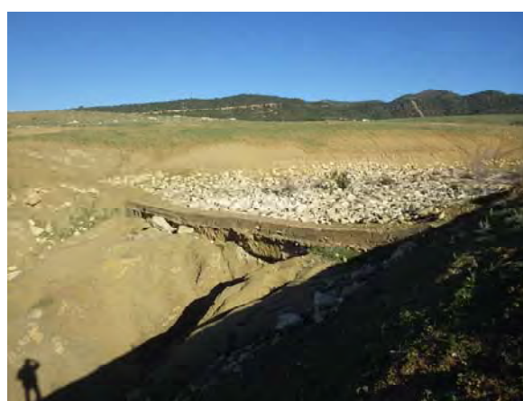
Point de départ du courant rapide du déversoir. Très érodé.
