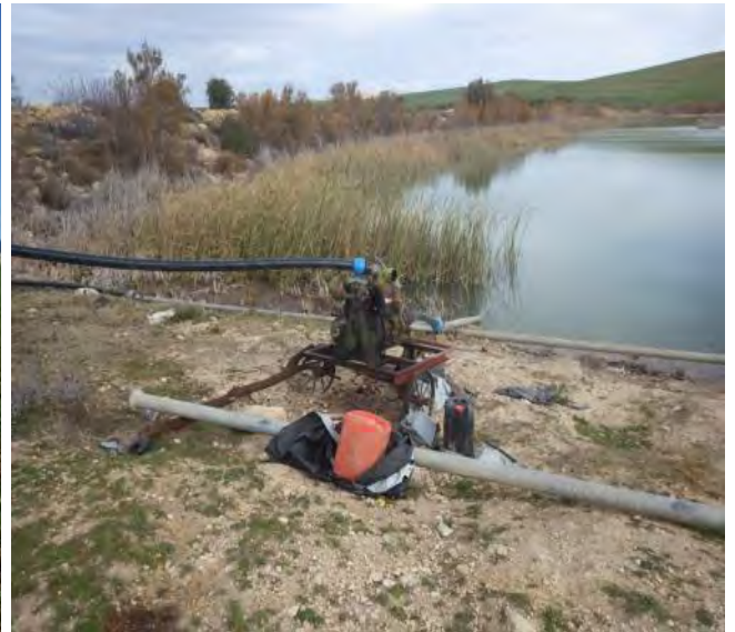
Figure 3.12 Pompe de captage à partir du bassin de retenue SI-2 Mechaiker (23 janvier 2014)
