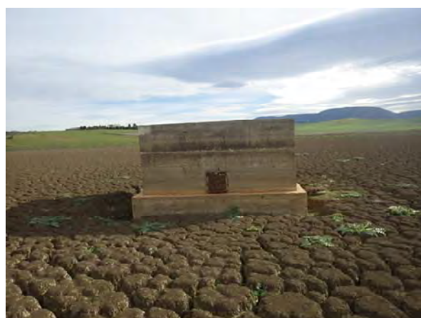
Sommet de la tour de prise d'eau et ensablement
