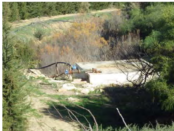
Ouvrage de décharge d'eau collectée et tuyau de distribution
