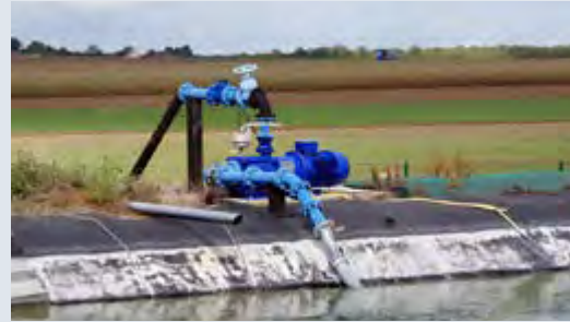
Photo n° 15 Pompage source de pression
