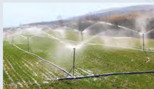
Photo n° 17 Conduites secondaires latérales fixes
