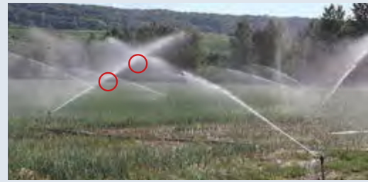
Photo n° 31 Exemple réel de la disposition des asperseurs
