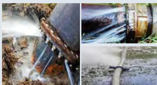
Photo n° 35 Défaillance de système d'irrigation
